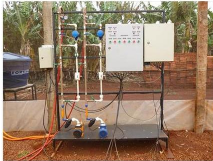
FIGURA 01 - Módulo do sistema comando e aquisição de dados
