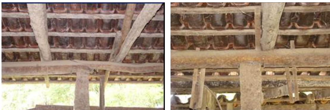
FIGURA 1. Fotos que mostram a linha da tesoura incidindo sobre viga/frechal e enfraquecimento do frechal sobre o pilar e erros construtivos.
