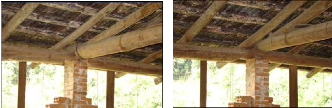
FIGURA 2. Fotos que mostram enfraquecimento do frechal próximo ao pilar da linha da tesoura, gerando esforços cortantes na madeira de alto risco de queda.
